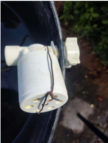
Beschädigte und mit Draht fixierte Nachlafeinheit – so soll es nicht sein
